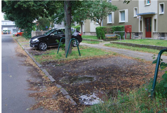
Parkstellflächen Im Tiergarten (sanierungsbedürftig)
