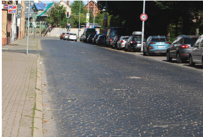
Ilversgehofener Platz (reparaturbedürftig)
