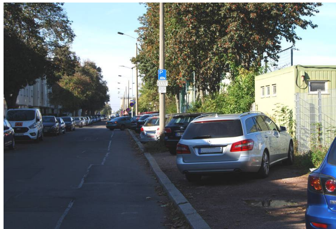
Parkstellflächen auf dem Gehweg, Grubenstraße (sanierungsbedürftig)
