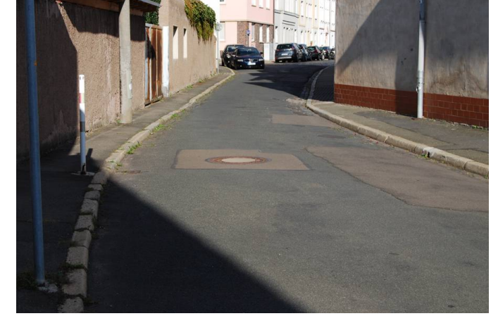
Bogenstraße, sanierungsbedürftig (Einbahnstraße)
