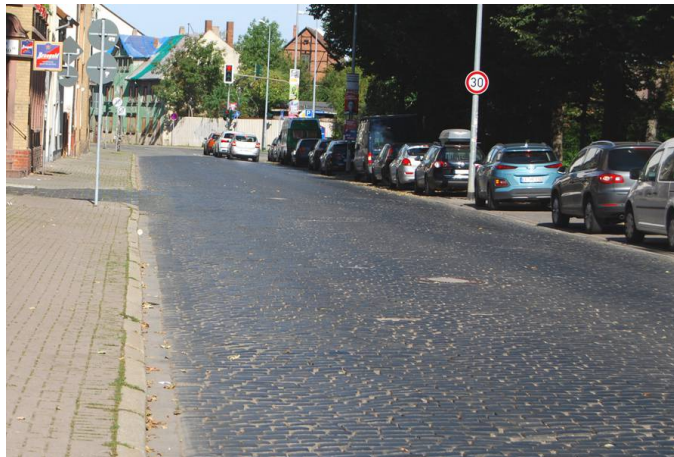
Ilversgehofener Platz, sanierungsbedürftig (Durchgangsstraße, Süd-Nord-Durchquerung)
